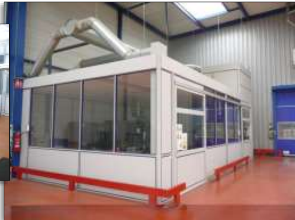
Au sein d'une zone AT mosphère EX plosible
